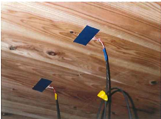
写真 2.4 天井センサ設置状況
