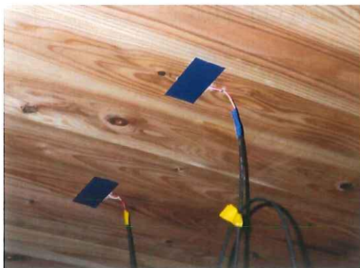
写真 2.4 天井センサ設置状況
