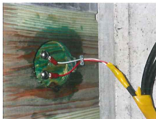
写真 2.5 基礎センサ設置状況
