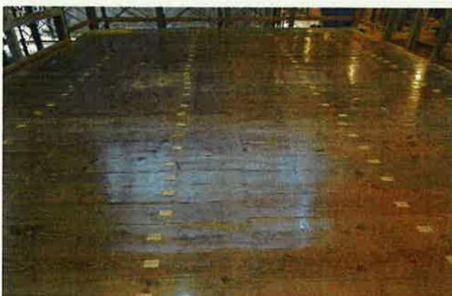
写真 12 資料館（旧本館）床板の状況（1階西教室）
