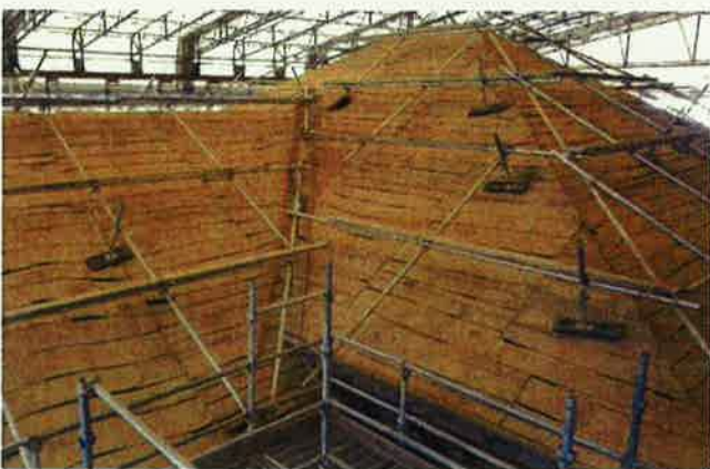
写真 4 資料館（旧本館） 野地板の状況
