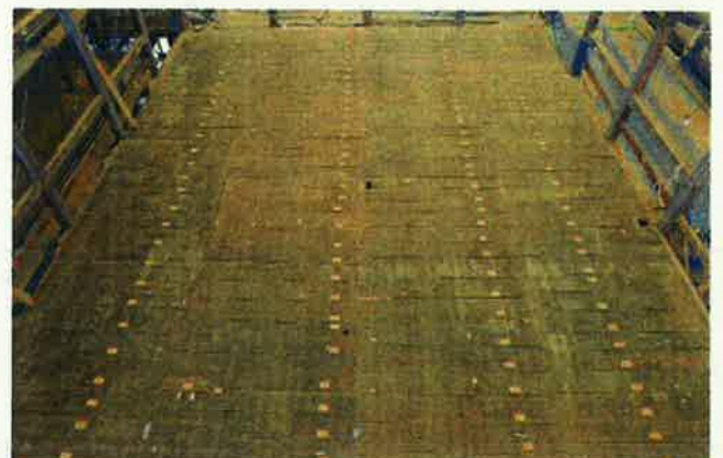
写真 9 資料館（旧本館）床板の状況（2階東教室）
