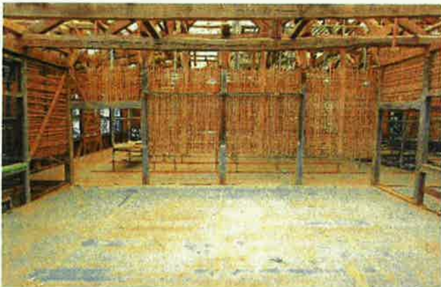
写真 8 資料館（旧本館）壁下地の状況（2階東教室）
