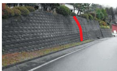
擁壁下端のハラミ出し
