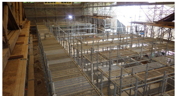
写真5 生涯学習施設・東廊下(旧東校舎)建方の仮設足場組立状況
