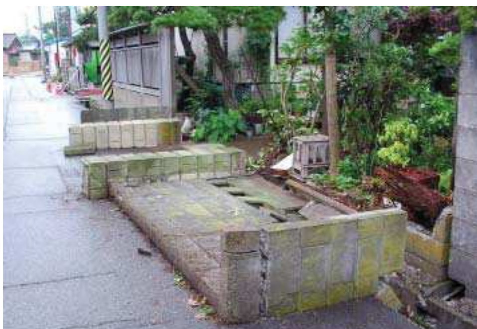
地震により、倒壊したブロック塀( 2007 年新潟県中越沖地震) (写真提供：埼玉県)
