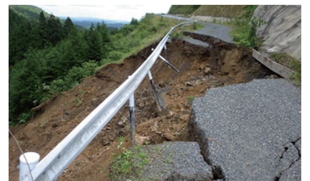
路体が崩壊した林道(真庭市)
