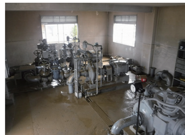
水道施設(送水設備)の被害状況
