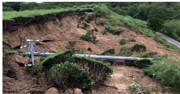
高梁市備中町での電柱被害
