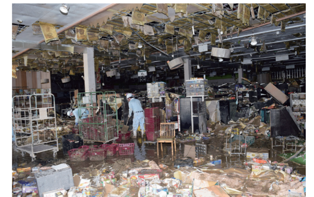
天井まで浸水したスーパー（倉敷市真備町）
