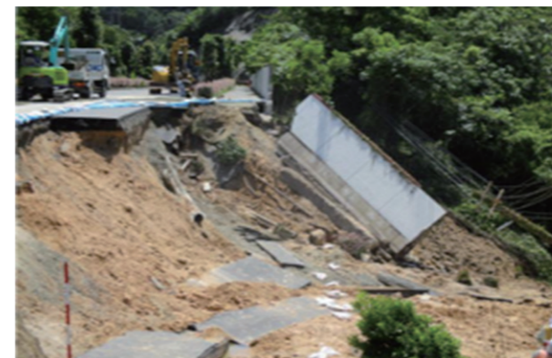
玉野市内の地下通信ケーブルの被害
