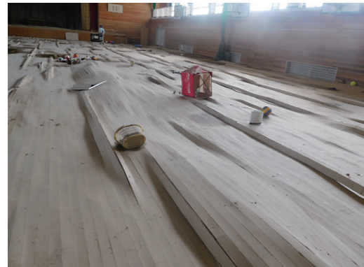
被災した体育館（倉敷市立真備東中学校）
