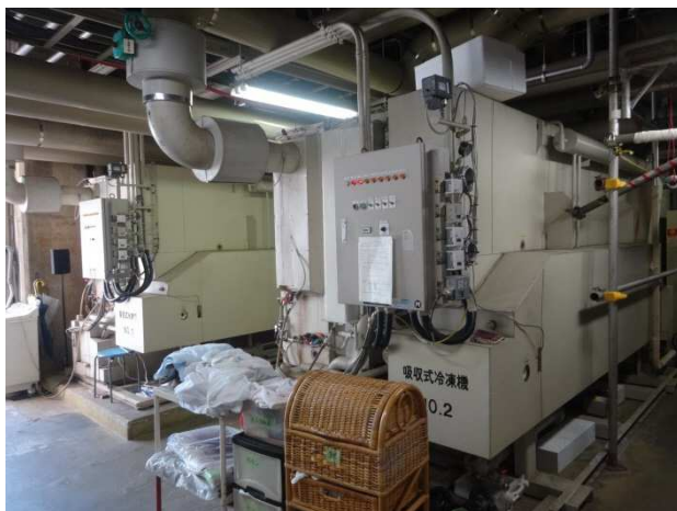
吸収式冷温水発生機
