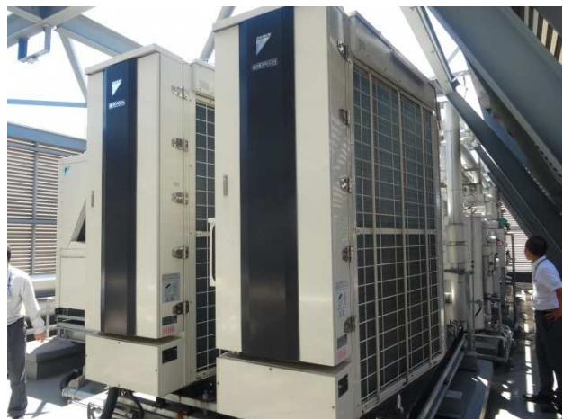
ヒートポンプチラー
