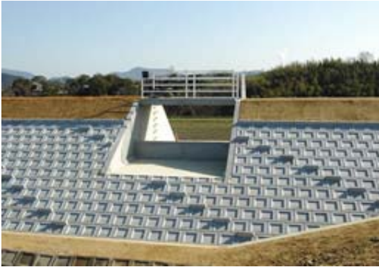
写真1：洪水吐 (香川県HPより)
