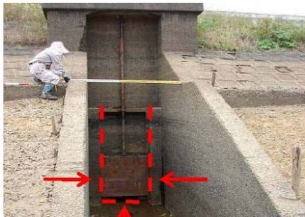
写真 37：ゲート周りの漏水
