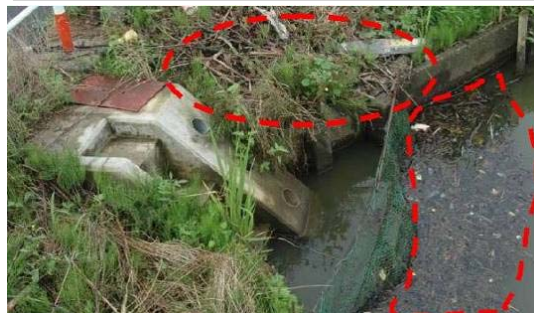
写真 38：取水部周辺の土砂やゴミの堆積
