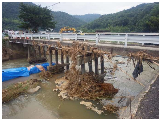
内田地内古屋谷橋崩壊
