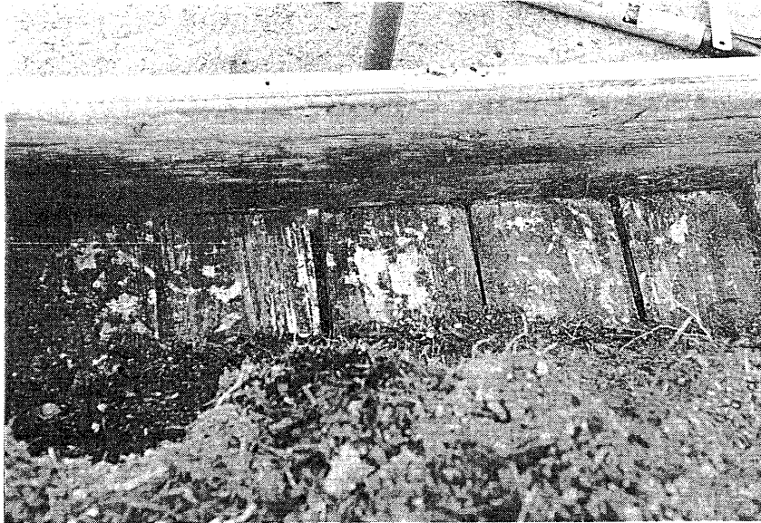
写真3 アカマツ無処理底板の腐朽状況
