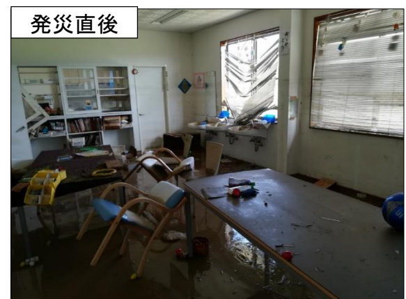
障害者施設の被災状況
