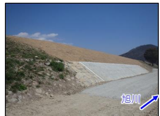
旭川（岡山市北区御津国ヶ原）の復旧状況
