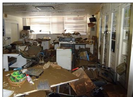
倉敷まきび支援学校の被災状況(倉敷市真備町)
