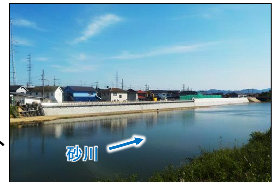
砂川（岡山市東区西大寺中野）の復旧状況
