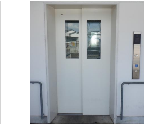
エレベーター
