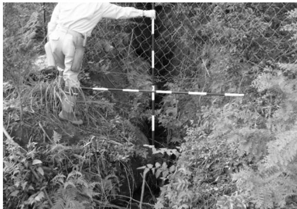
図-19 設置方法不良（水路）
