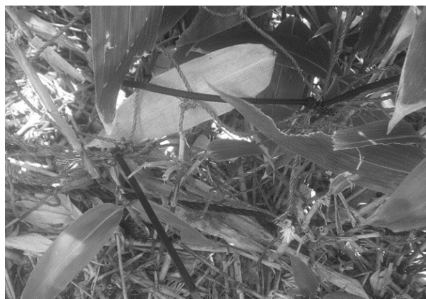
図-4 ネット補修（結束バンド）
