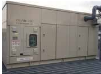
アンモニア冷媒冷凍機
