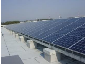
太陽光パネル (50kW)
