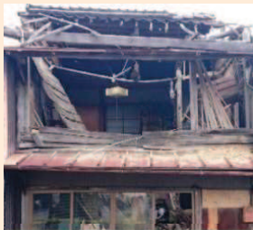
対象：老朽危険空き家
