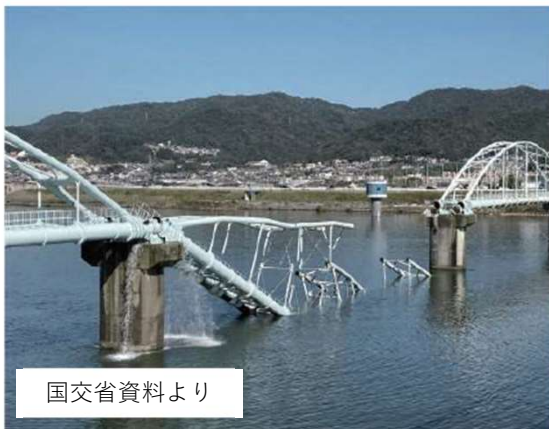
< 水管橋の落橋 >
