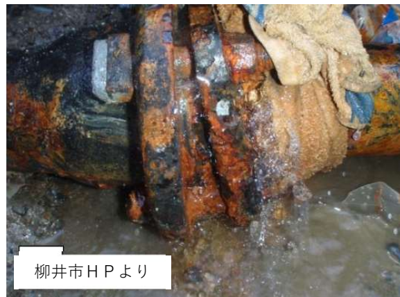
< 水道管継手部からの漏水 >
