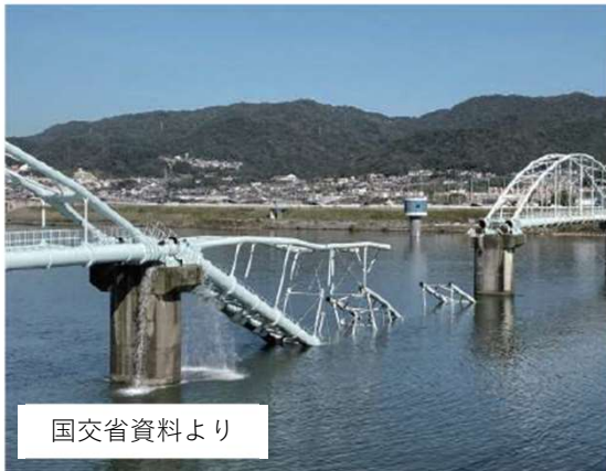
＜水管橋の落橋＞
