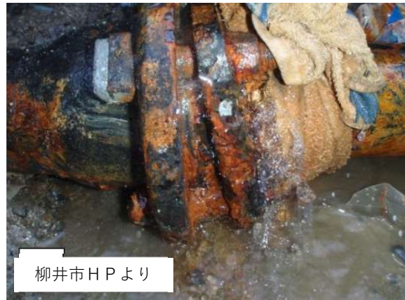
＜水道管継手部からの漏水＞
