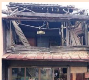
対象：老朽危険空き家
