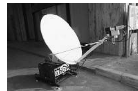
(衛星回線接続用アンテナ)
