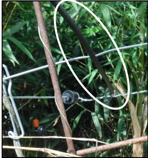
被覆電線の接続箇所
