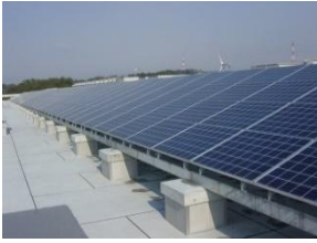
太陽光パネル (50kW)
