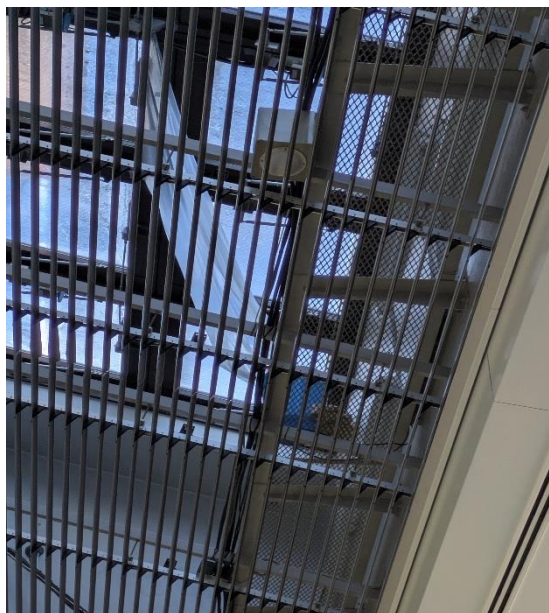
国際線上部(水漏れ状況)
