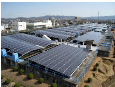
西之浦浄水場太陽光発電(企業局)
