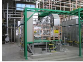
都市ガスボイラー（6t/h）
