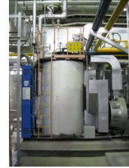
空調用都市ガスボイラー（2.5t/h）
