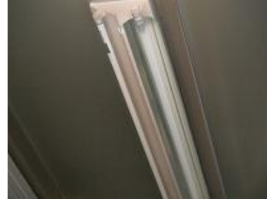
インバーター照明の間引き対策
