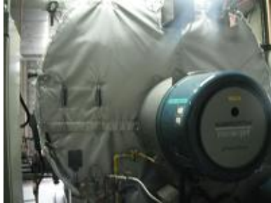
ボイラー本体の保温対策
