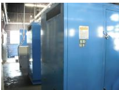
コンプレッサー設置状況
