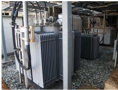
トランス設置状況
