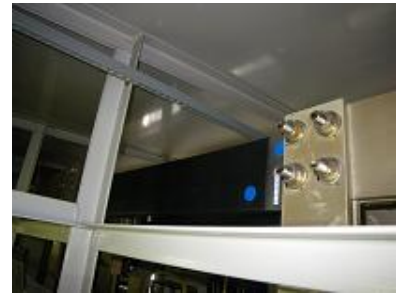
銅バー連結状況
