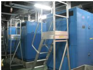
150kW コンプレッサー
