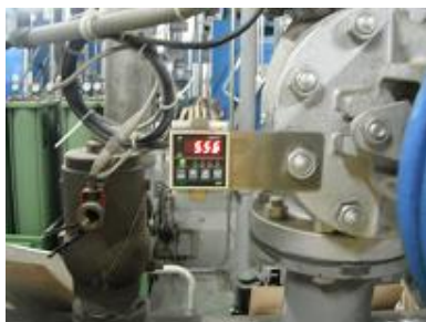
圧力低減対策状況
