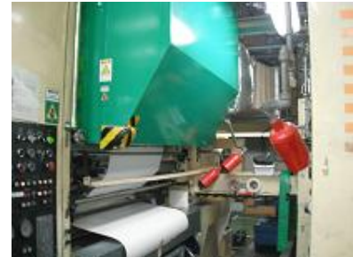
グラビア印刷乾燥機 ※緑部分で熱風乾燥を行っている
