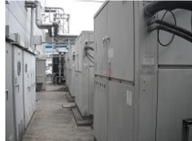
空冷チラー設置状況
