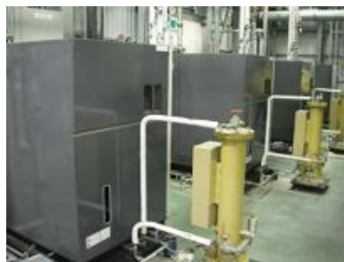
75kW コンプレッサー
