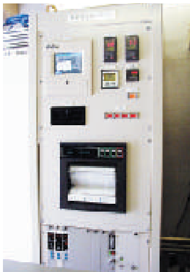
空間ガンマ線測定装置
