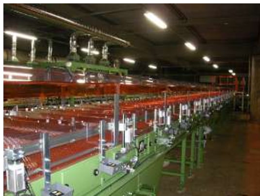
コンベアの稼働状況
