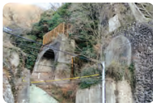
↑日羽～美袋間、坑門がコンクリートで塞がれた旧地蔵嶽トンネル(右)。
