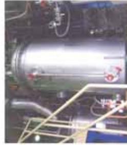
● 精製処理タンク
