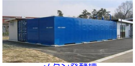
メタン発酵槽
