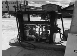
損壊した計量機
