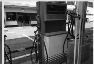
損壊したガスコンプレッサー
