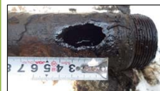
【腐食した埋設配管】
