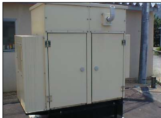
非常用発電機
