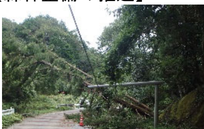
倒木により電線断線
