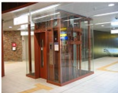
（エレベーター）
