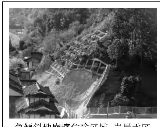
急傾斜地崩壊危険区域 岩屋地区
