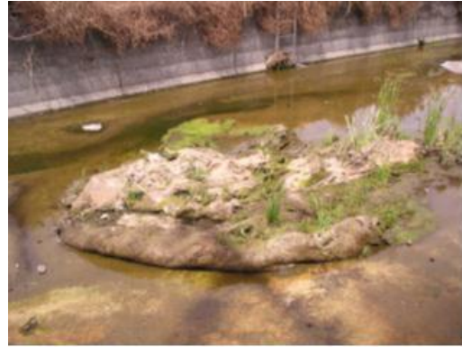
土砂の堆積状況
