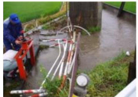
ゲートへのごみや流木の流入状況
