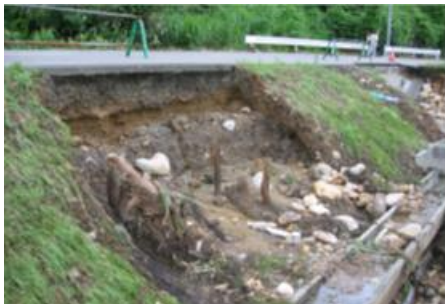
道路法面の崩壊状況
