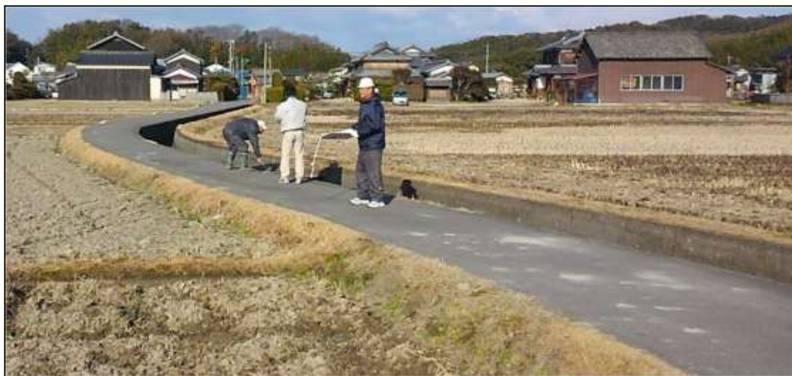
長寿命化活動で整備した農道舗装（砂利道からコンクリート舗装に）
