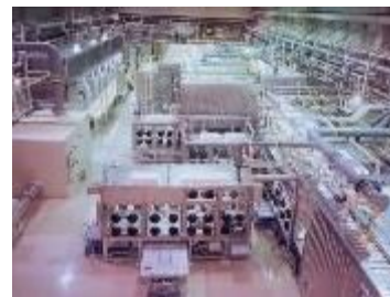
遠心機処理設備
