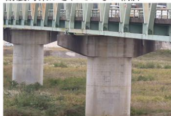
耐震対策がされていない橋脚
