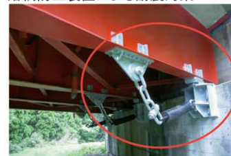
落橋防止装置による耐震対策
