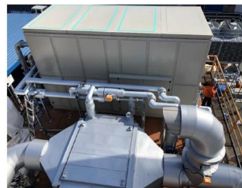
バイナリー発電設備
