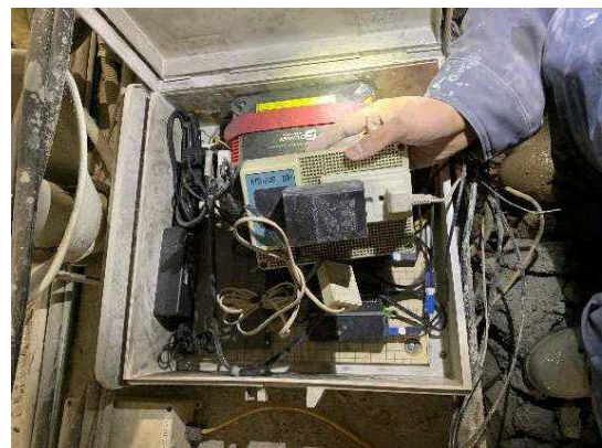
【坑内wi-fiシステム】
