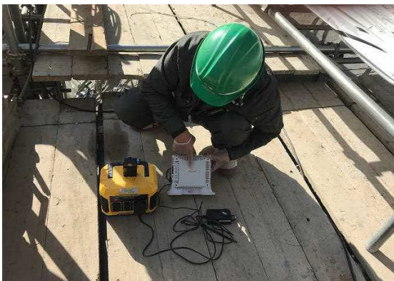
【屋内電波改善装置、ポータブル電源】
