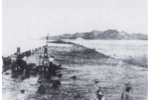
当時の干拓潮止め堤防工事の様子 海の中に堤防を築く大変な難工事だった。 向こう側に見える山は、児島半島です。 (写真提供：児島湾中央管理事務所 児島湾干拓資料室)
