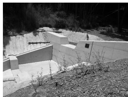
地域の安全を守る谷止工
