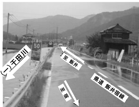
浸水多発箇所（飯井工区）
