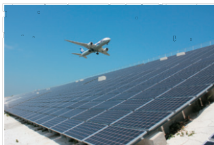
岡山空港太陽光発電所
