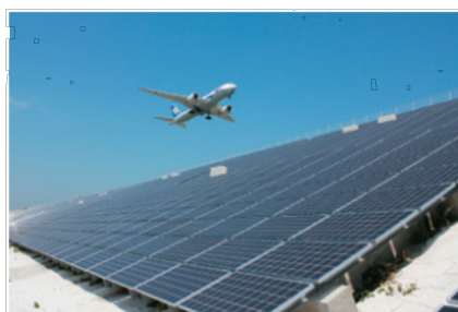
岡山空港太陽光発電所
